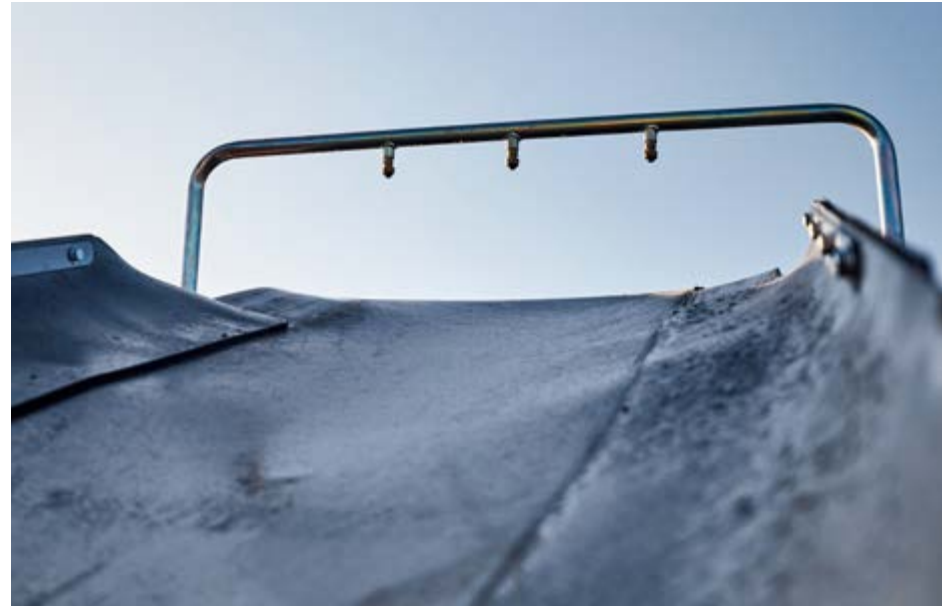
Sistema de difusión de agua con bomba de presión, para una supresión eficiente de polvo.
