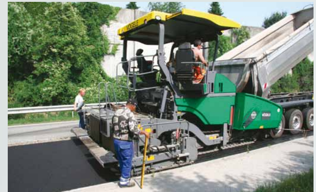
Le poste ErgoPlus® de conduite
